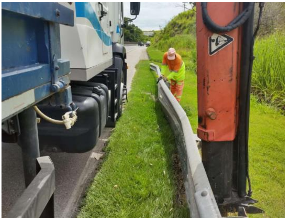
FOTO 04 - Dispositivo de segurança – Km 10+500 Norte [2]
